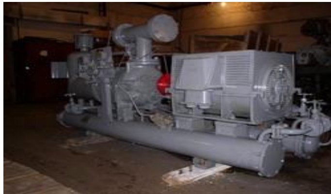
Рис. 1.1. Зовнішній вигляд компресорного агрегату
